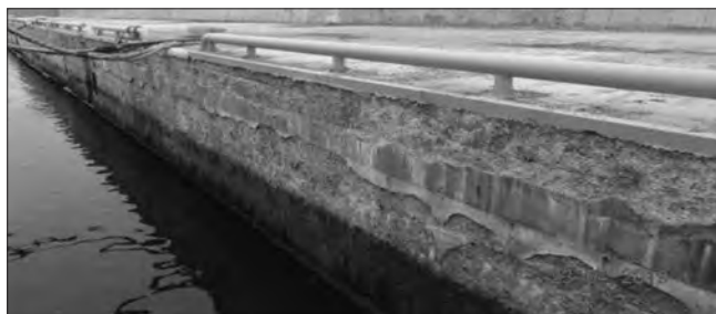
Рис. 5. Глобальное разрушение бетона в монолитной надстройке верхнего строения после первого зимнего сезона вида P_{C2} – отслоение поверхностной части бетона с последующим объемным разрушением внутренних слоев (объект КЗ-3, табл. 1)
