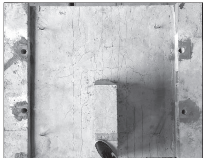
Рис. 4. Схема трещин на верхней поверхности плит. Образец ПО-2 Fig. 4. Diagram of cracks on the upper surface of the plates. PO-2 prototype
