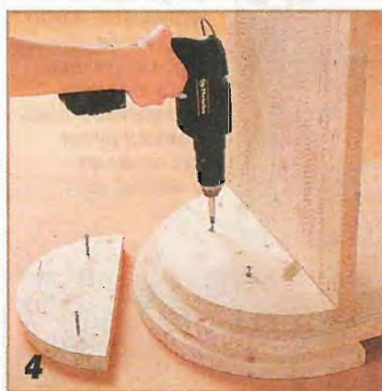
4 Вырезанные полукруглые плиты крепят на клею и шурупах к нижнему и верхнему горизонтальным щитам корпуса. Позднее эти шурупы будут закрыты половинками труб.
