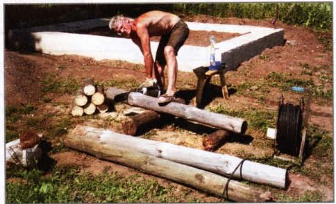
Щиты опалубки сняты. Следующая операция — гидроизоляция верхней плоскости бетонного цоколя. Но перед этим придётся заготовить дрова для костра, чтобы разогреть битум
