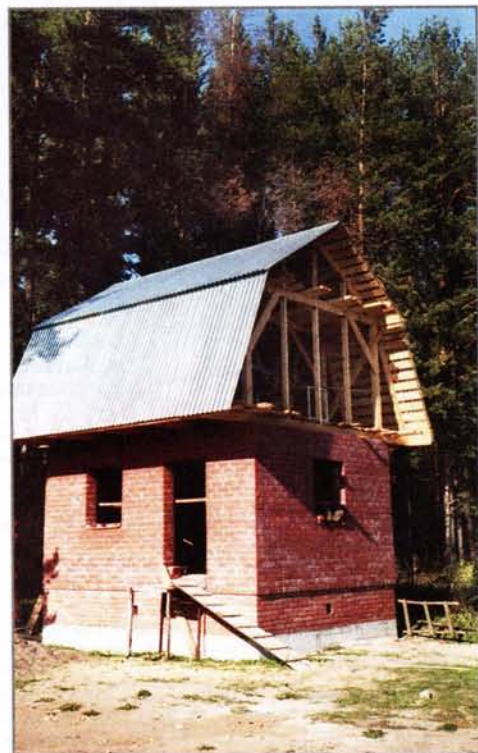
Ещё утром верхняя часть дома представляла собой скелет из стропил и обрешётки, а к концу дня уже сияла на солнце оцинкованными листами
