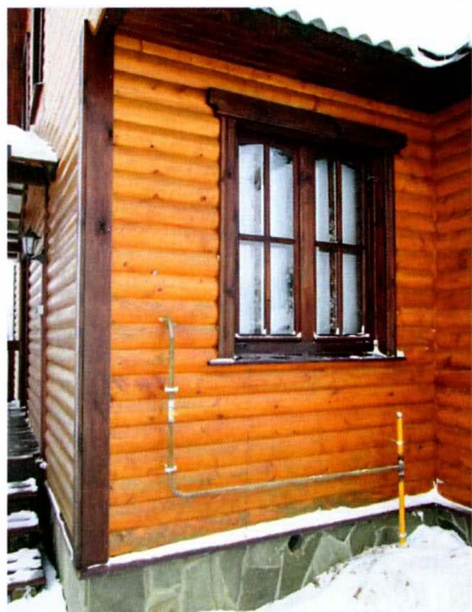
В дом введён газовый трубопровод с запорным краном. Весной его покрасим в жёлтый цвет.
