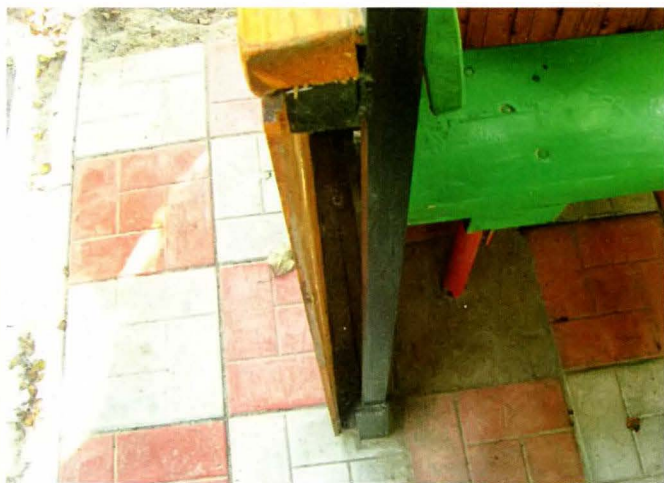
Стойка дверного проёма приварена к отрезку уголка, замоноличенного в бетонное основание.
