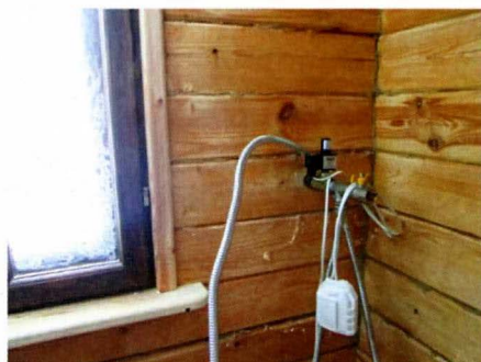
Ввод газопровода в котельной с электромагнитным запорным клапаном и ручным запорным краном.
