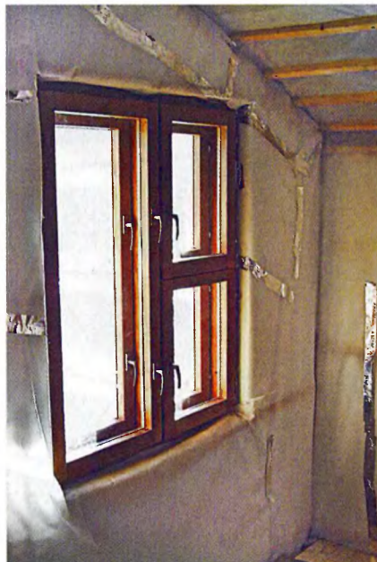
Стены и крыша изнутри также закрыты паронепроницаемой плёнкой. Стыки между полотнами плёнки тщательно заклеены скотчем.
