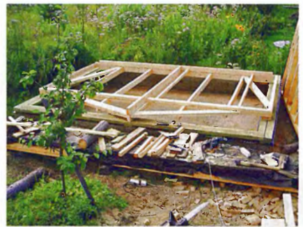
Каркас фронтовой стены собран таким образом, чтобы потом можно было уложить утеплитель расчётной толщины.
