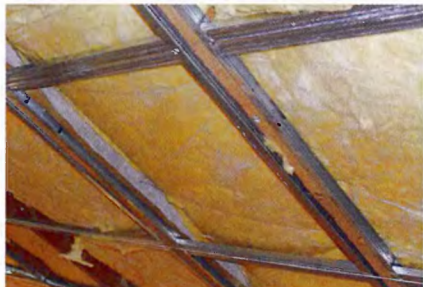
Внутреннее утепление стен дома может способствовать перегреву помещения в жаркое время.
