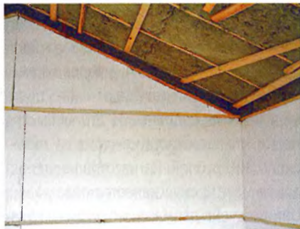
Двухслойное утепление стены: наружный слой — базальтовая вата толщиной 100 мм, внутренний — пенополистирол толщиной 50 мм.
