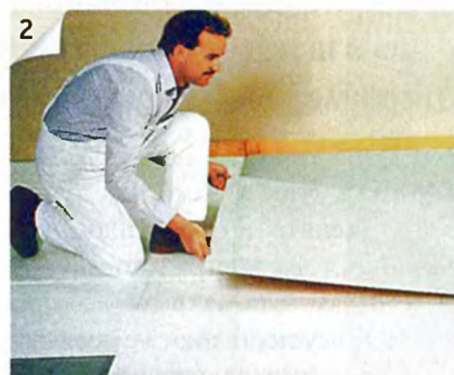
2 ГКЛ чёрного пола укладывают в два слоя поверх плит изоляции и прочно склеивают друг с другом.
