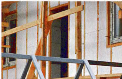
Наружное утепление стен материалами с паропроницаемостью ниже, чем у стеновых материалов, может привести к увеличению расходов на отопление из-за отсыревания стен.
