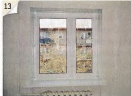
13 Примыкающие к окну участки стены грунтуем и шпатлюем под последующую декоративную отделку.
