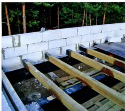
Перекрытия по деревянным балкам с вентилируемым подполом — устаревшая нерациональная конструкция.
