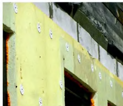
Надёжный способ испортить дом из ячеистого бетона — «утеплить» его паронепроницаемым ЭППС.
