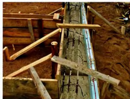
При длительных перерывах в бетонировании фундаментов рабочие швы должны быть не горизонтальными, как на снимке, а вертикальными.
