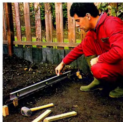
После выемки грунта в землю забивают колышки, обозначающие границы и уровень покрытия площадки.
