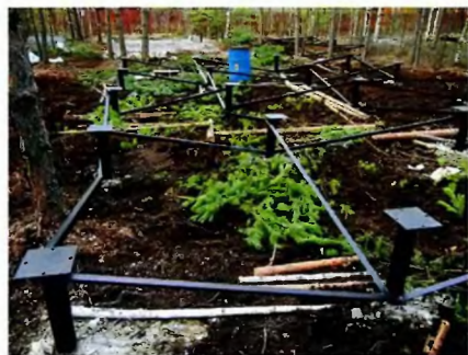
Использование винтовых свай на химически агрессивном органическом грунте (торфянике) приведёт к ускоренной коррозии металла.
