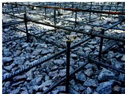
Гальваническая связь арматурного каркаса фундамента с грунтом способна увеличить скорость электрохимической коррозии.
