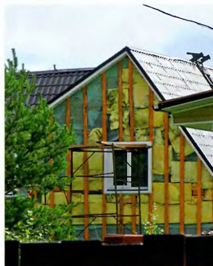
Такой монтаж утеплителя не имеет ничего общего с утеплением. Сплошное утепление деревянных конструкций пенополиэтиленом (зеленоватый цвет на снимке) обеспечит быстрое биологическое разрушение деревянных конструкций.
