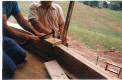
Выступающее изогнутое окно опирается на подоконник из досок сечением 50 × 150 мм. Каждая деталь подоконника идентична элементу обвязки под ней.
