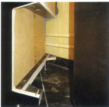
Горизонтальные трубы, идущие к радиатору отопления, частично спрятались за тумбами, не примыкающими к стене. А вот в крайней тумбе, установленной в правой части зеркальной секции, пришлось вырезать проём и перенести заднюю стенку внутрь на 10 см — это позволило разместить тумбу вплотную к стене. Труб в левой части зеркала не было, поэтому установить там тумбы общей длиной 120 см не составило особого труда.
