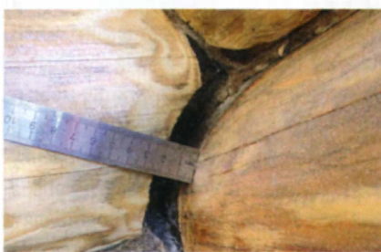
Стыки в угловых соединениях должны быть идеально подогнаны и проложены межвенцовым утеплителем. На фото — грубое нарушение строительных норм.
