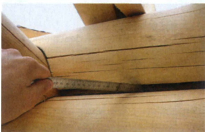
Стыки брёвен или брусев в стенах должны быть утеплены (джут, пакля, мох), а межвенцовый зазор не должен превышать 1 мм + толщина утеплителя.
