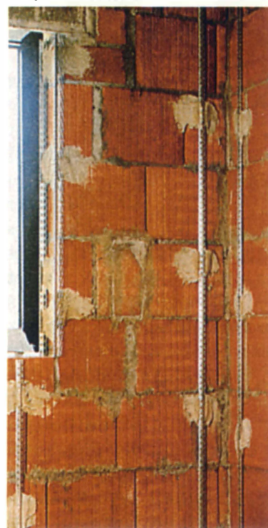
С помощью маяков можно легко и ровно оштукатурить и внутренние углы. Маяки устанавливают не в сам угол, а по обе стороны на расстоянии примерно 8–10 см от угла.
