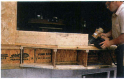
Стыки рам не попадают на лаги, поэтому для распределения нагрузок от окна на лаги установили сдвоенные перемычки сечением 50 × 200 мм.
