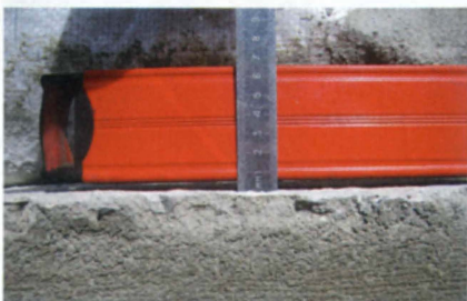
На поверхности цокольной части дома не должны наблюдаться перепады высоты свыше 5 мм.
