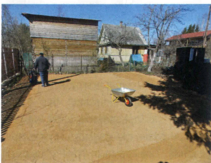
Песчаную подушку под фундамент в виде монолитной железобетонной плиты утрамбовывают слоями по 20 см с помощью виброплощадки. А проливать песок водой для его уплотнения недопустимо: это может привести к размытию грунтового основания.
