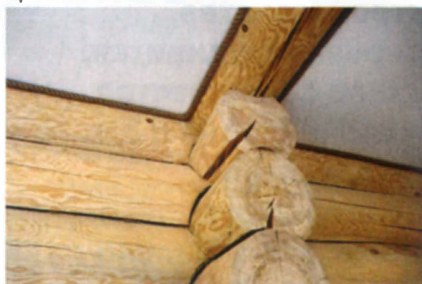
Ширина раскрытия трещины оговаривается в проекте. При наличии верхнего раскрытия трещин со стороны улицы необходимо использовать герметик по дереву для заделки полостей.
