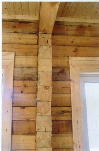
Наличие сквозных зазоров при стыковке бревна или бруса запрещено строительными нормами. Просвет в стене — нарушение технологии при монтаже.
