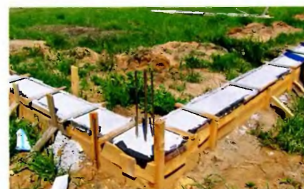
Благодаря бетонному основанию забор обладает высокой надёжностью. В откопанной траншее устраивают песчаную подушку и заливают бетон.
