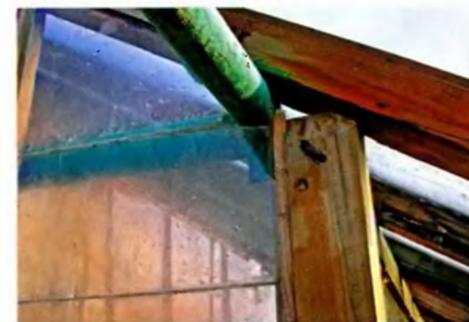
Стёкла на боковой стене поставлены встык друг с другом. Предварительно на стыкуемые грани нанесён прозрачный герметик.
