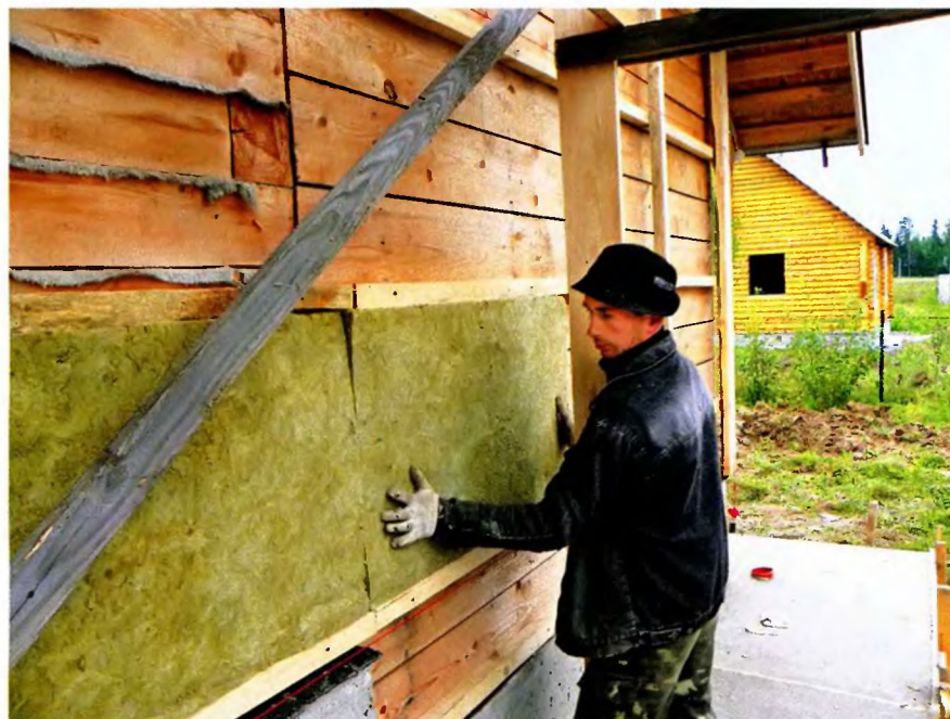
В срубе из бруса 150 × 150 мм можно не делать пароизоляцию. А если утеплить его снаружи, то такой дом становится пригодным для проживания зимой.
