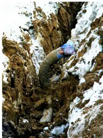
На короткий кусок перфорированной трубы надели пакет, чтобы почва не попала внутрь дренажной системы.
