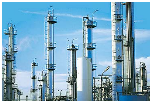
Рис. 34. Ректификационные колонны на нефтеперерабатывающем заводе
