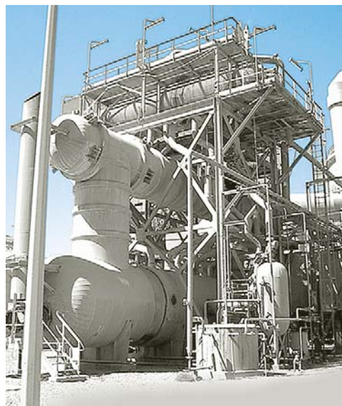
Рис. 72. Колонна синтеза аммиака
