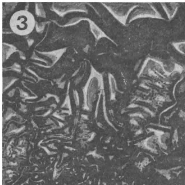
Рис. 8. Разрушение лакокрасочного покрытия в результате воздействия влаги:
