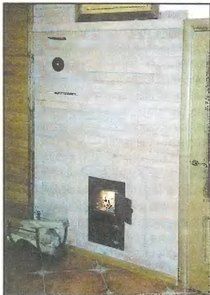
Металлическая печь в кирпичной облицовке и с отопительным щитком. Вид на печь из комнаты отдыха.
