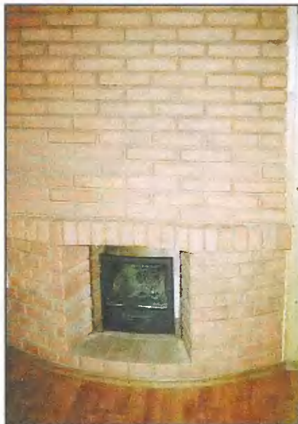
Металлическая печь «Harvia», обложенная кирпичом. Вид из комнаты отдыха. Кладка выполнена из красного кирпича марки М-200.
