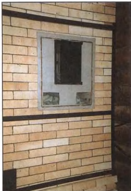
Корсет банной печи сварен из стальных полос и уголков.
