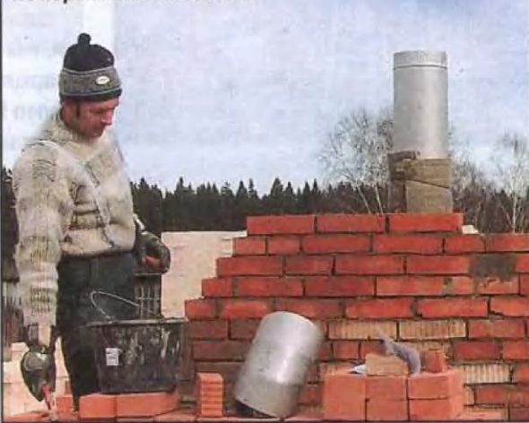
В основу дымохода заложена труба из нержавейки Ø250 мм.
